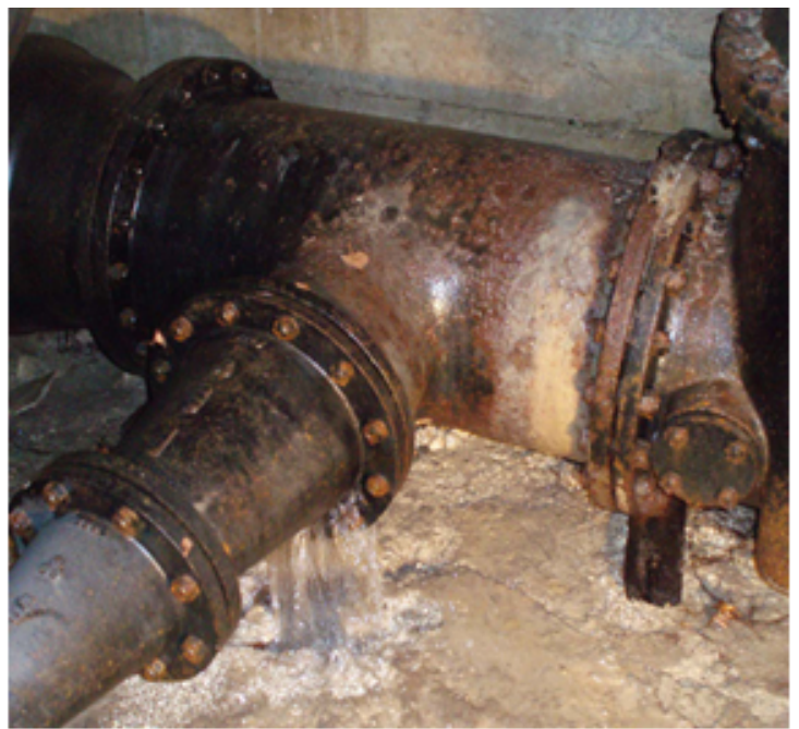
Durch Korrosion werden Leitungen schleichend zerstört.
