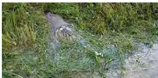
Abb. 51 (links oben): Zu schmale Deichkronen und Bewuchs führen zu einer stärkeren Durchsickerung und Materialaustrag.
