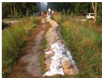
Abb. 50 (rechts): Bauwerks- und Straßenanschlüsse an Deiche stellen bei direkter Anströmung ein erhebliches Erosionsrisiko dar. Das gleiche gilt hinsichtlich innerer Erosion für in den Deich einbindende Bauwerke.
