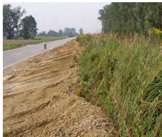
Abb. 30 (links): Um den luftseitigen Böschungsfuß zu sichern oder die Erreichbarkeit eines gefährdeten Deichabschnittes zu ermöglichen, müssen manchmal umfangreiche Erdarbeiten durchgeführt werden.
