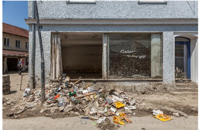
Abb. 1: Schäden an einem Ladengeschäft in Simbach durch das Hochwasserereignis 2016. Ablagerungen/Rückstände können zur Dokumentation des Ereignisses genutzt werden. Quelle: ATELIER TOEPFER
