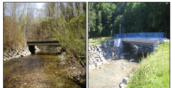
Abb. 3: Praxisbeispiel Markt Weitnau; Gewässerquerschnittsertüchtigung (links: alte Brücke, rechts: neue Brücke). Quelle: WWA KE.
