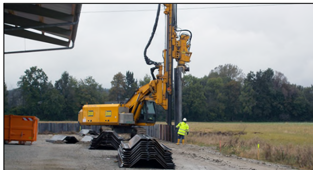
Abb. 5: Praxisbeispiel Ampfing; Bau einer 580 Meter langen Hochwasserschutzmauer als Spundwand, Quelle: Internetangebot des Wasserwirtschaftsamtes Rosenheim
