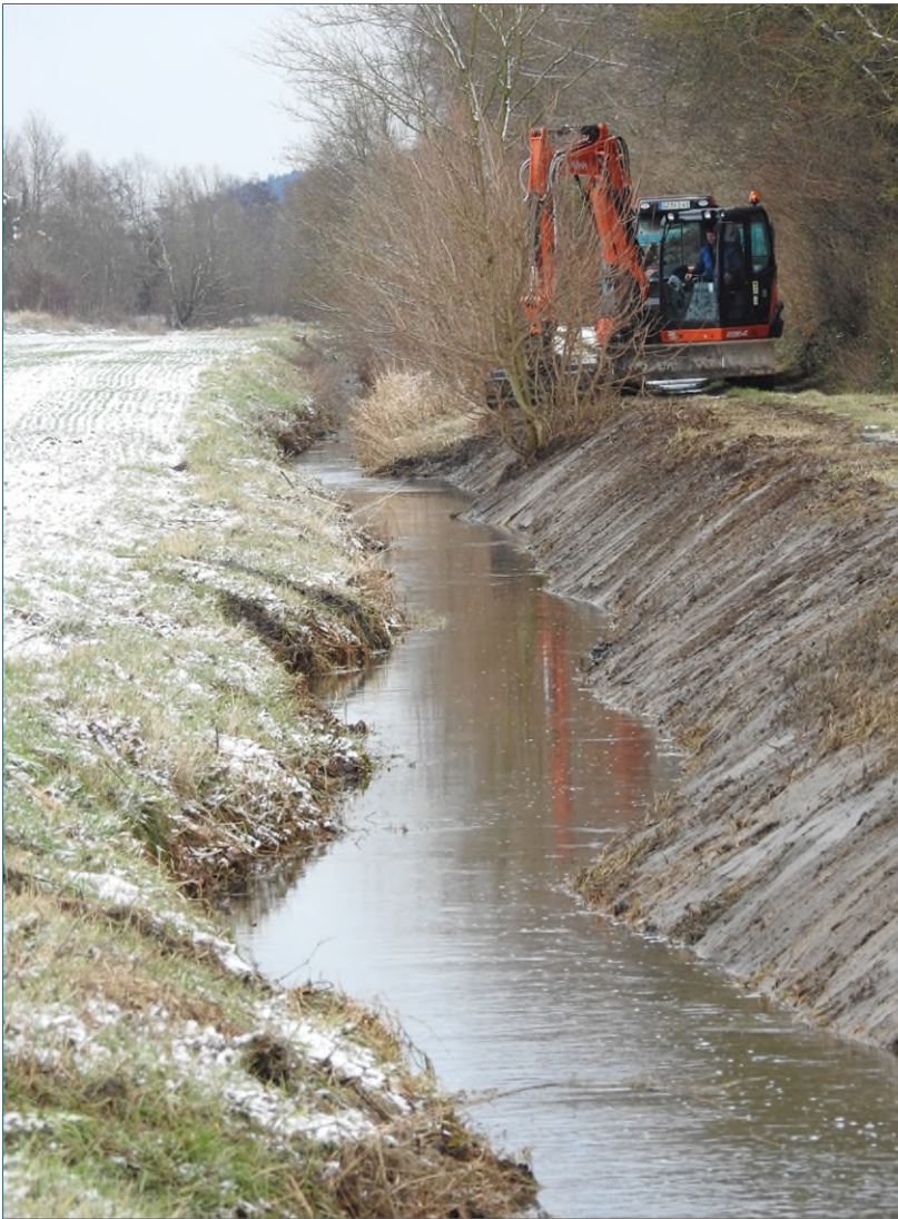
Abb. 7: Unterhaltungsmaßnahme, die augenscheinlich das erforderliche Maß der Unterhaltung überschreitet
