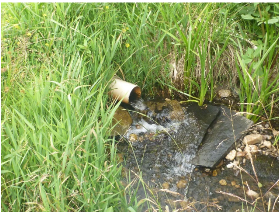
Einspeisen aus Teich
