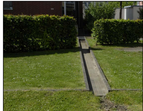
Sammelrinne zur Ableitung auf Rasenfläche
