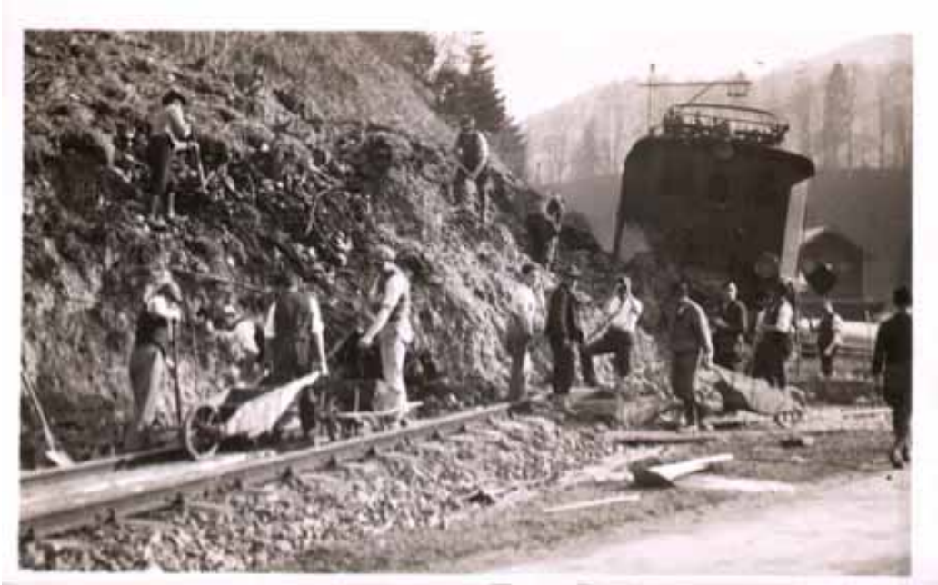
Abb. 5: Rutschung in Berchtesgaden im November 1928 (Archiv: Gemeinde Berchtesgaden)
