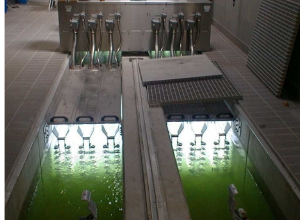
Abb. 137: Kläranlage mit UV-Bestrahlung (Isar in Bad Tölz, Oberbayern)
