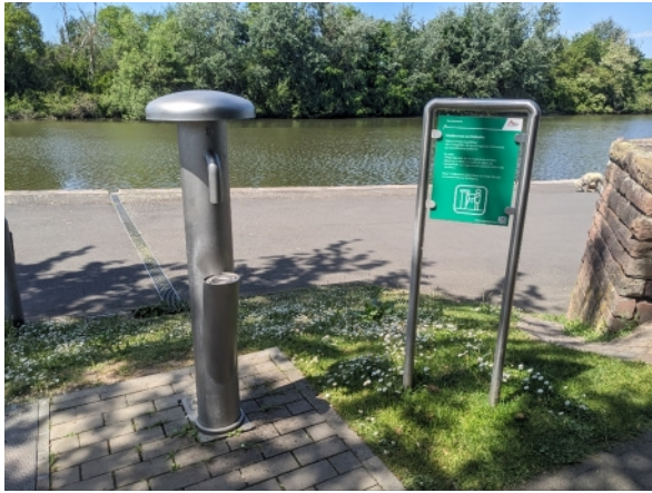
Abb. 125: Trinkwasserbrunnen an einer Uferpromenade (Main in Aschaffenburg, Unterfranken)
