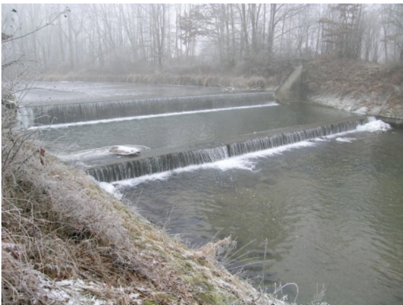
Abb. 150: Vorher: Mehrstufiger Absturz als Gefahrenquelle und unüberwindbar für aquatische Lebewesen vor dem Umbau zur Sohlgleite (Isen in Winhöring, Oberbayern)
