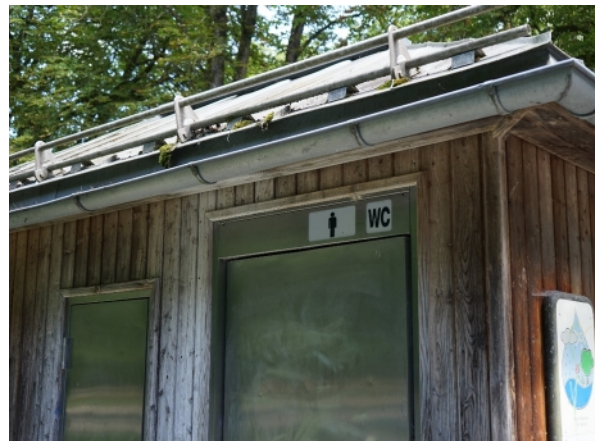
Abb. 128: Permanente Sanitäreanlage im Naherholungsgebiet (Lech in Augsburg, Schwaben)
