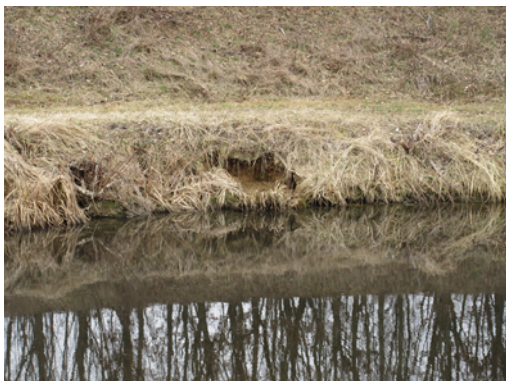
Abb. 11: Höhle eines Nagetiers in der Böschung
