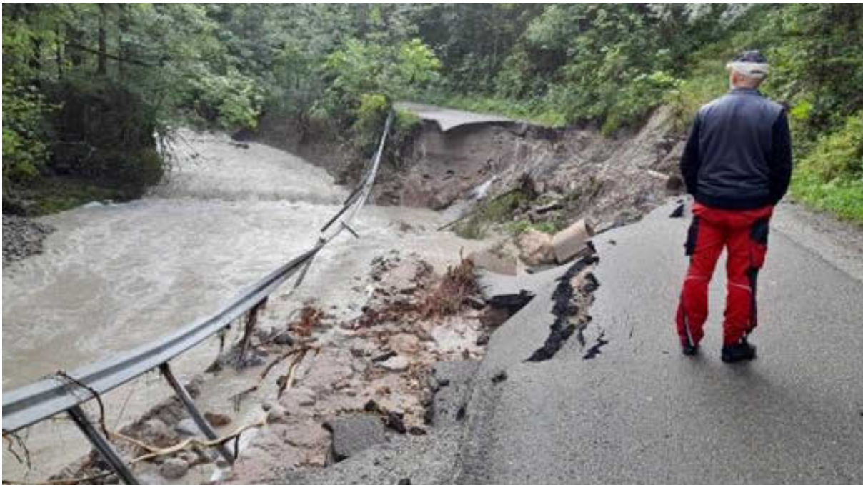
Abb. 64: Durch Uferanbruch zerstörte Straße im Mühlthal (Steinbach, Nussdorf am Inn) (Foto: WWA Rosenheim)
