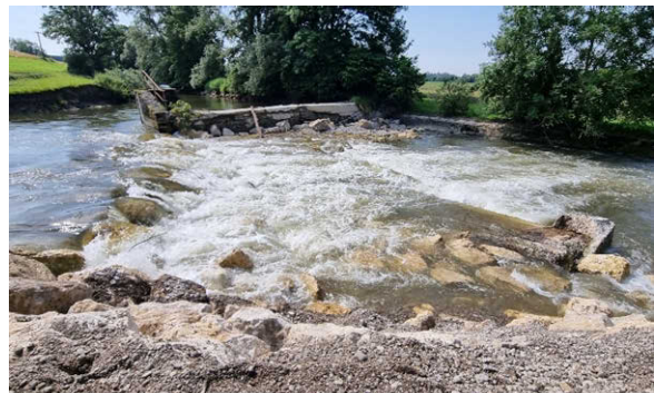
Abb. 51: Günstwehr bei Inneberg nach dem Hochwasserereignis (Foto: WWA Kempten)
