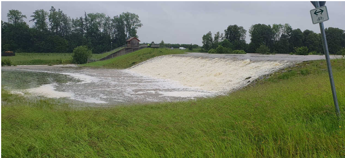
Abb. 39: Beaufschlagte Hochwasserentlastungsanlage an einem HRB im Landkreis Unterallgäu (Foto: WWA Kempten)
