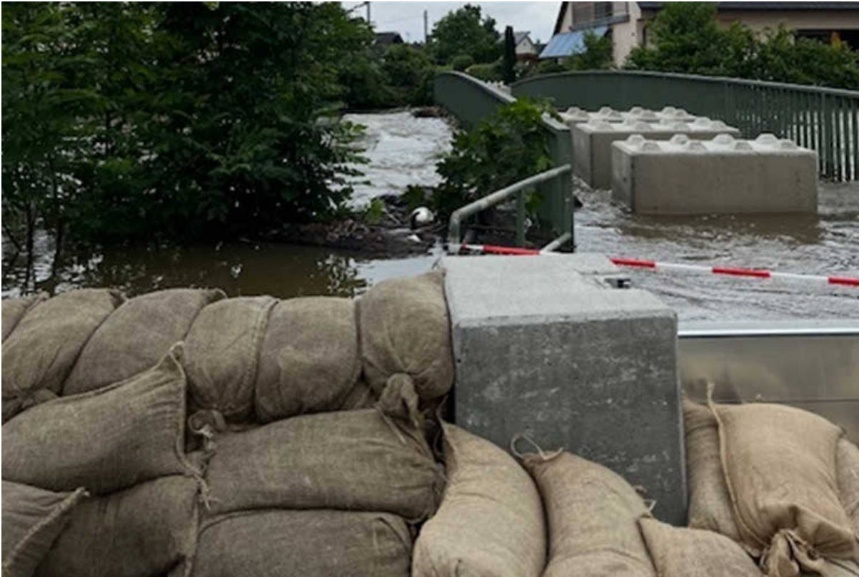
Abb. 101: Im Bereich des Paarstegs in Manching kam es zur Überströmung des Stegs. Dies führte zu einem Rückstau und einer teilweisen Verklausung. Die Einsatzkräfte reagierten schnell, erhöhten die Sandsackbarrieren und beschwerten den Steg zusätzlich mit Betonelementen (Foto: WWA Ingolstadt).
