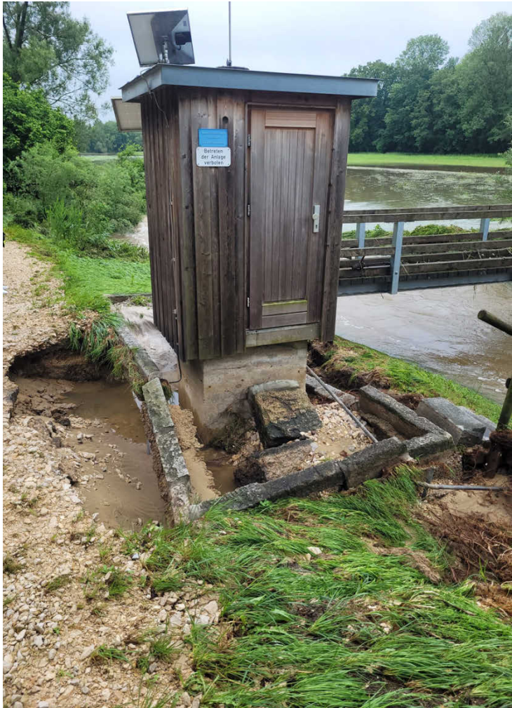
Abb. 33: Schäden am Pegel Blumenthal/Ecknach durch das Hochwasserereignis (Foto: WWA Ingolstadt)
