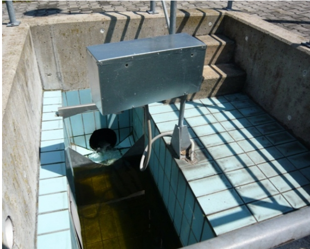
Abb. 3: Dreieckmesswehr in Betrieb
