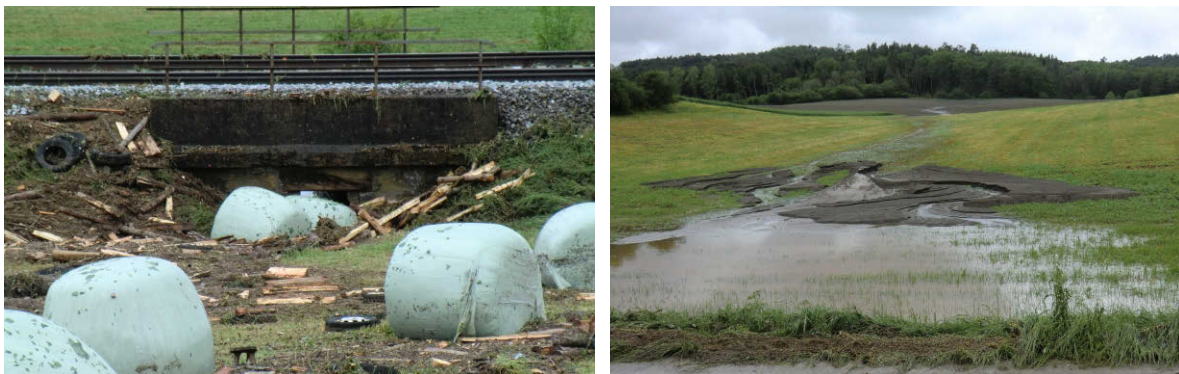
Abb. 5: Durch Oberflächenabfluss mobilisierte Gegenstände verklausen den Durchlass unter einer Bahnlinie (links). Aus einem Acker erodierte Feinstoffe werden in tieferliegenden Bereichen abgelagert (rechts).
