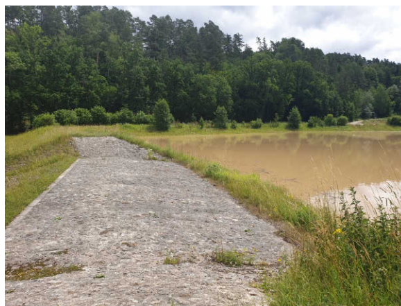
Abb. 31: Zurück gehaltenes Wasser im Becken 3 (re) „Attenkofen“. Das Wasser ist durch abgeschwemmtes Bodenmaterial bräunlich gefärbt.
