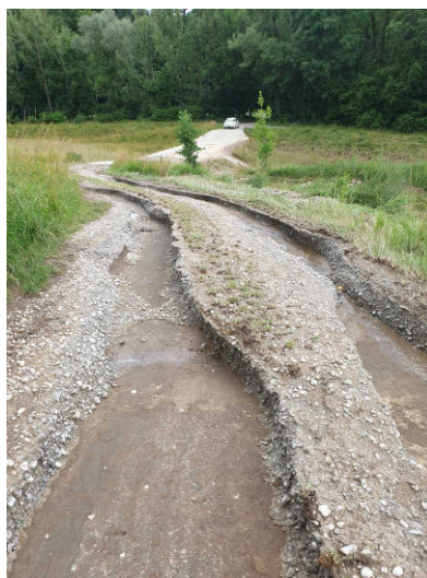
Abb. 35: Ausgespülter Weg mit Blickrichtung Becken 2 (rechts) und 3 (links).
