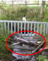
▲ Geschwemmsselrechen vor einem Durchlass schützt vor Verkläusung
