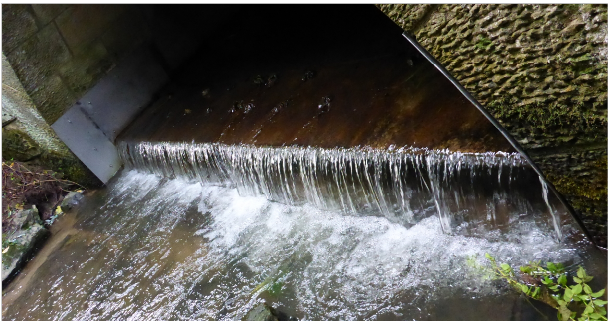
Abb. 2: Ad Hoc-Krebssperre an einem Sohlabsturz mit einer einfachen seitlichen Edelstahlverkleidung.
