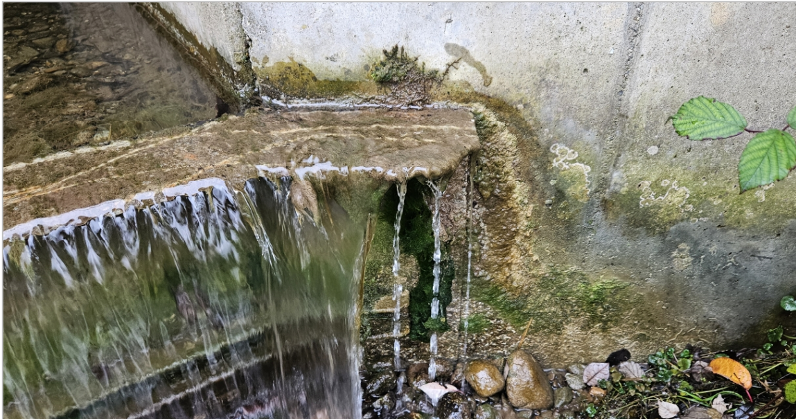
Abb. 4: Aufwuchs, Versinterung und Schwemmgut können die Funktion einer Krebssperre mindern.
