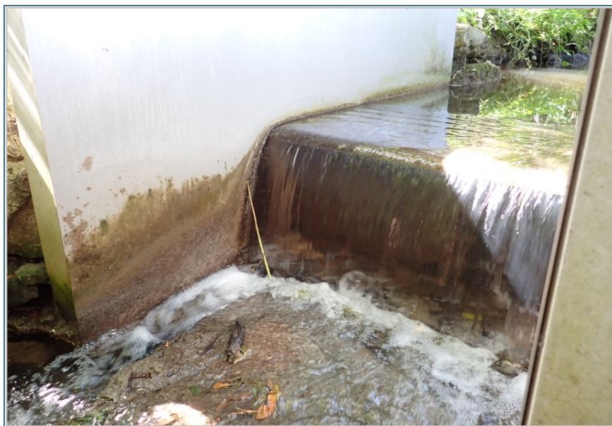
Abb. 3: Generische Krebssperre - eigens mit Hilfe eines Betonblocks kreierter Absturz, der mit Edelstahlblechen verkleidet wurde. Mit weiteren Betonplatten seitlich und daran angebrachten Edelstahlverkleidungen wurden alle potenziell für Flusskrebse geeigneten Wanderkorridore unpassierbar gestaltet.
