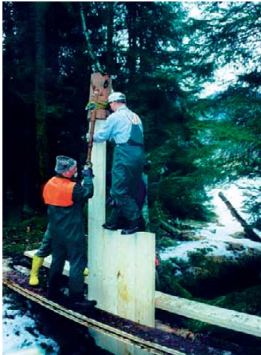
Abbildung 37: Abdichtung von Torfdämmen durch Bretterkonstruktion. Nebengraben im Torfstichgebiet des Bergener Mooses (Lkr. TS - Foto R. STROHWASSER).
