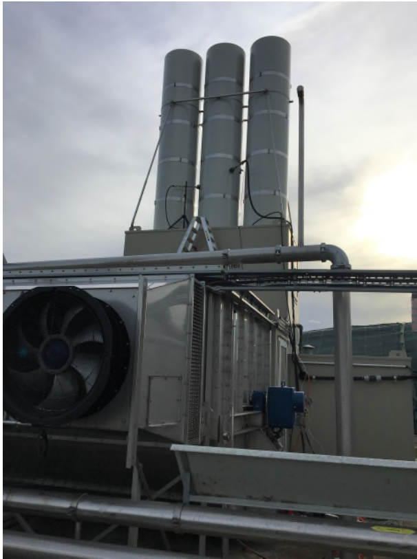
Abb. 23: Schaufelradrockner Betrieb A mit Abluftreinigung nach Betreiber Anlage A (2019)
