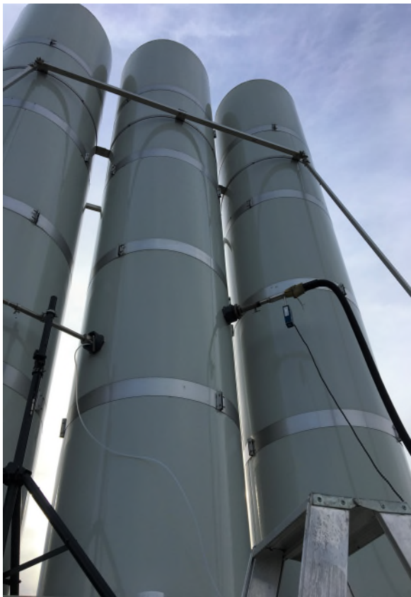
Abb. 24: Rein-gasmesssstelle Anlage A nach Betreiber Anlage A (2019)
