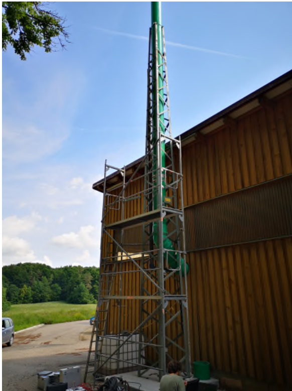
Abb. 38: Reingasmessstelle Anlage C nach Betreiber Anlage C (2021)
