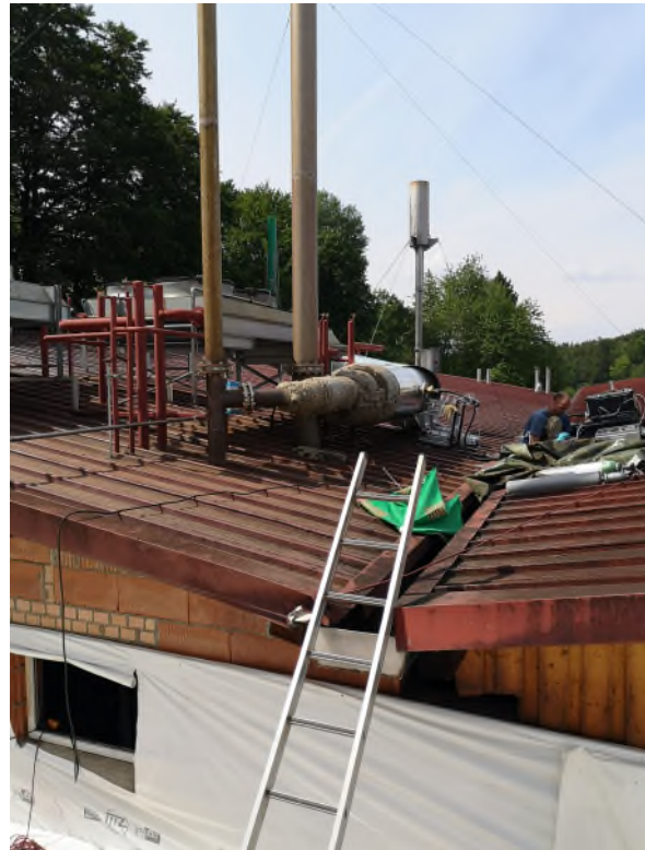
Abb. 39: Messstelle BHKW-Abgas Anlage C nach Betreiber Anlage C (2021)
