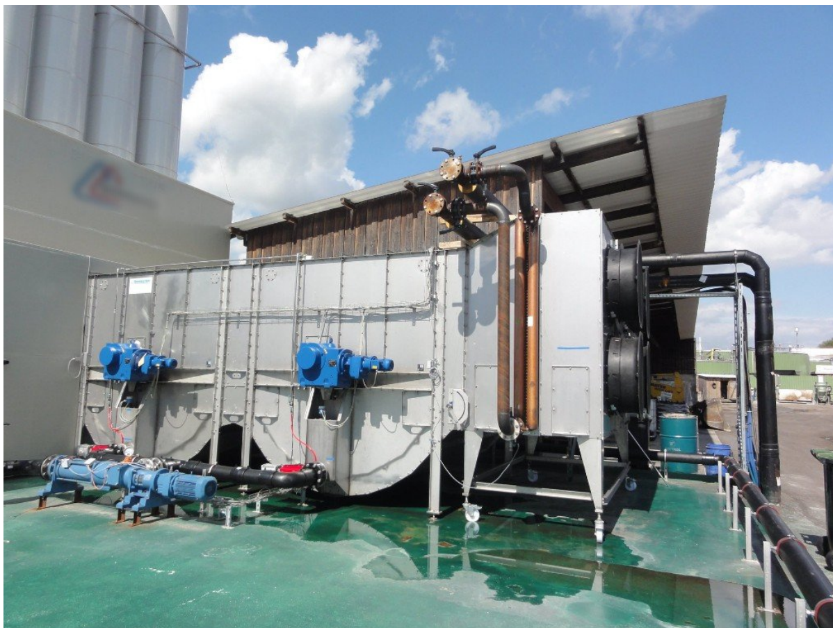
Abb. 14: Beispielanlage eines Schaufelradrockners mit zwei Wannen nach Einkammerer
