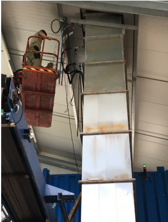
Abb. 32: Reingasmessstelle Kamin Anlage B nach Betreiber Anlage B (2020)
