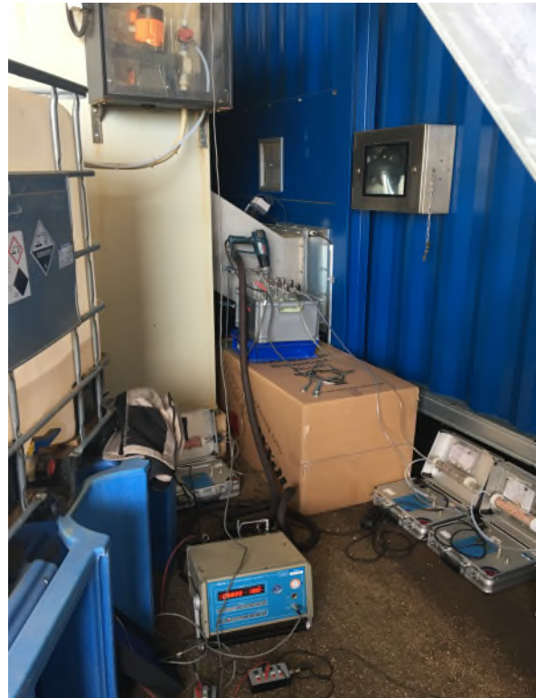
Abb. 33: Rohgasmessstelle vor Wäscher Anlage B nach Betreiber Anlage B (2020)
