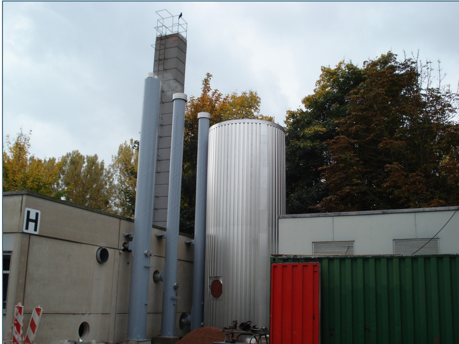
Abb. 21: Heizwasserpufferspeicher mit 50 m³ Inhalt
