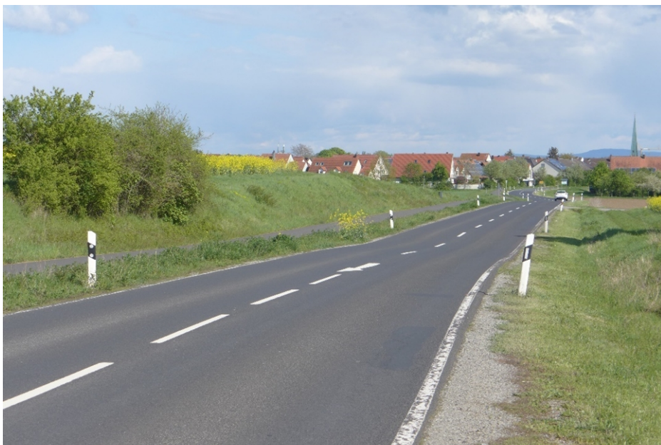
Abb. 17: Eindellung einer Asphaltstraße westlich Bergheinfeld vermutlich aufgrund von Laugungsprozessen im Untergrund (Grundgips)
