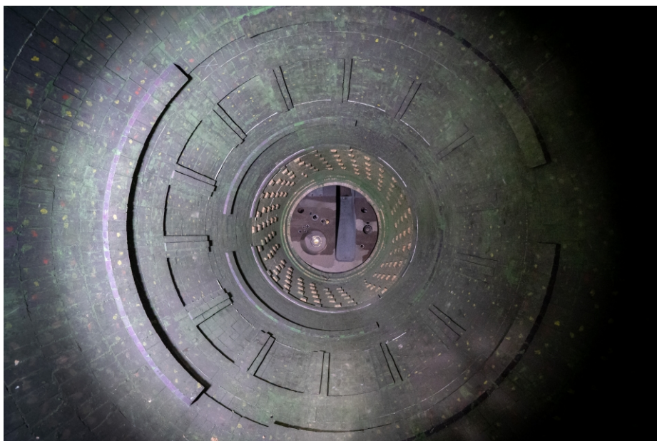
Abb. 2: Drehrohröfen GSB Baar-Ebenhausen
