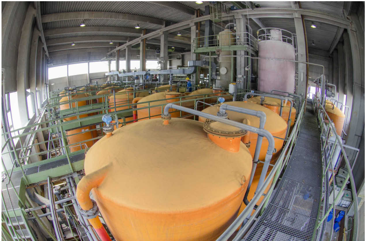
Abb. 9: Chemisch-physikalisch-biologische Reinigungsanlage der GSB in Baar-Ebenhausen
