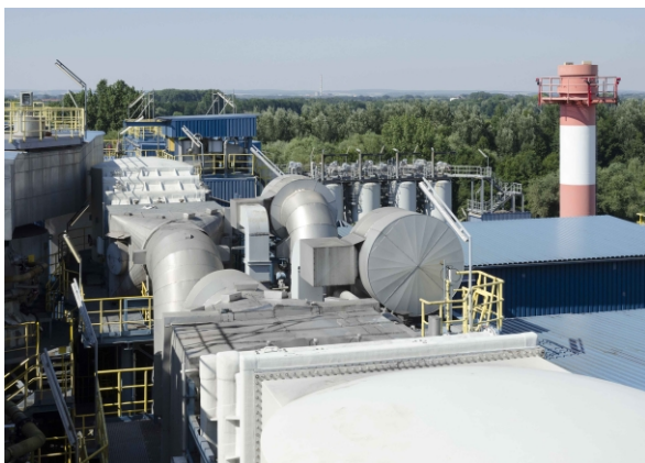
Abb. 1: GSB-Verbrennungslinie 3 in Baar-Ebenhausen
