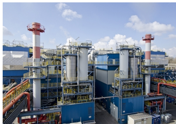
Abb. 6: Sonderabfallverbrennungsanlage der GSB in Baar-Ebenhausen
