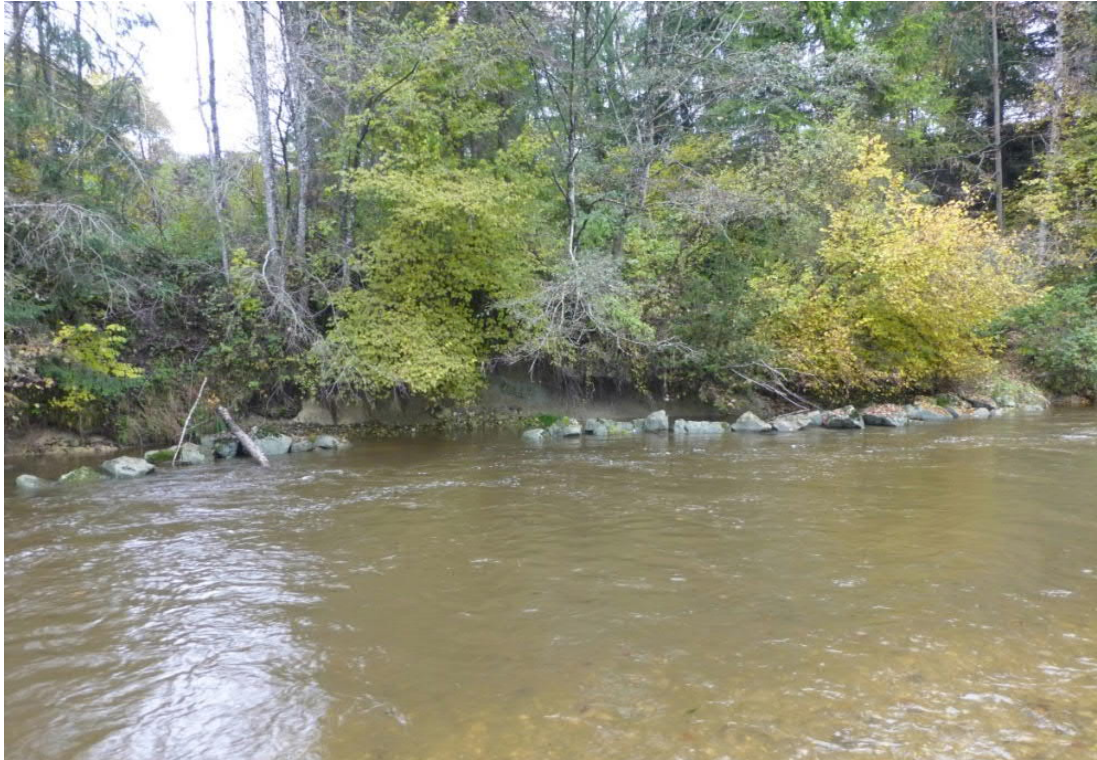
Abbildung 30: Uferbefestigung an der Wertach – vom Wasser unterspült (Foto: E. Pfau, A-ELF Ansbach)
