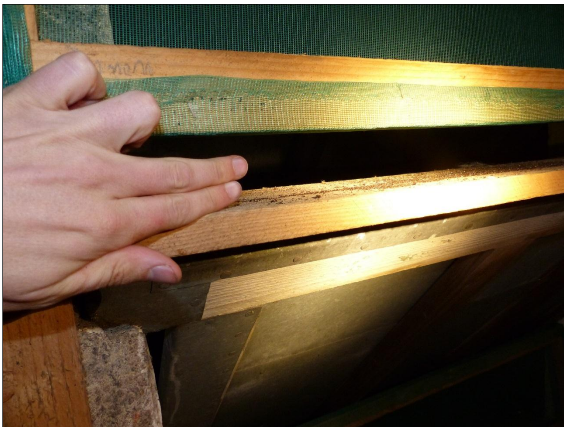
Abb. 2.2.4 – 4: Spalten in den Netzen vor den Schallluken dienen als Hauptausflug
