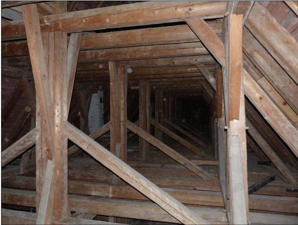
Abb. 2.2.5 – 6: Dachboden im Bereich der Haupthangplätze der Kolonie, oberhalb des wertvollen Barocksaals, Kot rieselt aktuell ungehindert auf den Boden unterhalb
