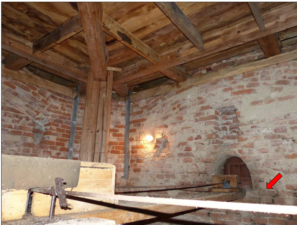
Abb. 2.2.1 – 6: Auf der Ebene der Kirchturmuhren (Ausflug, siehe Pfeil) befindet sich eine Lampe ohne Zeitschaltuhr
