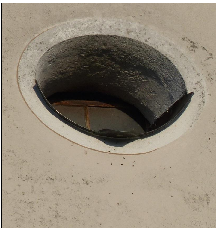
Abb. 2.2.5 – 3: Detailansicht des Einfluges durch das runde Fenster, deutliche Kotspuren
