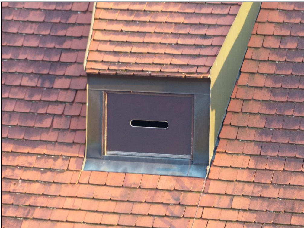
Abb. 2.2.5 – 7: Dachboden im Dachstuhl des südlichen Klostergebäudes (in einem anderen Gebäude als das aktuelle Quartier der Mausohren), innen mit Spaltquartieren, Wärmeglocken, Verdunkelung und freien Einflügen für Fledermäuse durch Pater Geißinger optimiert
