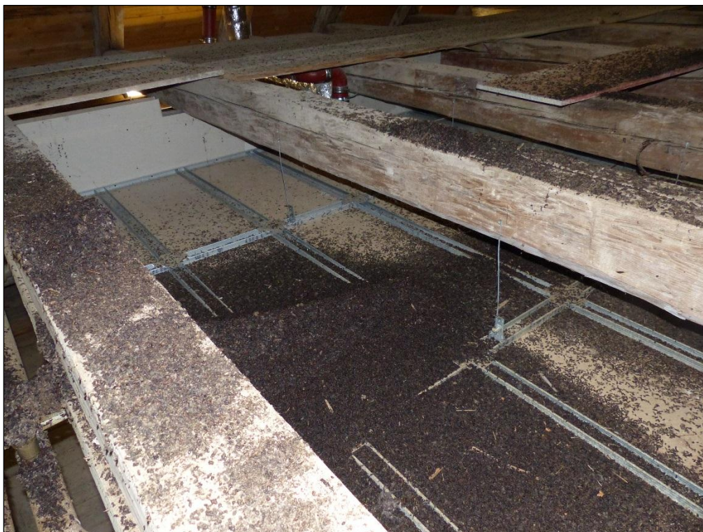
Abb. 2.2.3 – 5: der Kot im aktuellen Quartier würde bei einer Nutzung des Dachbodens vermutlich Konflikte verursachen
