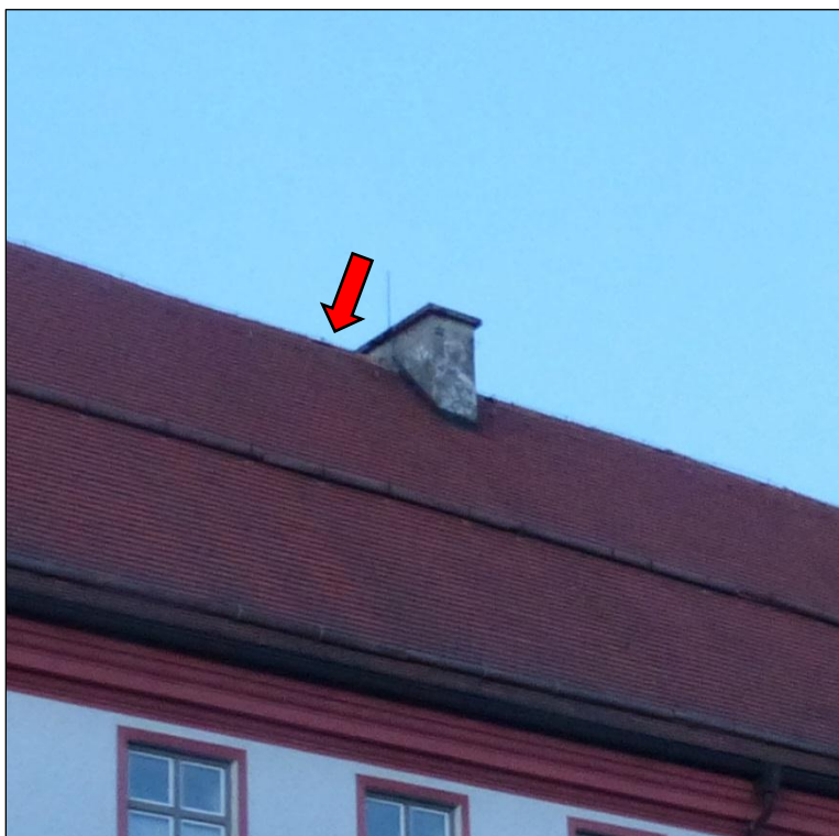
Abb. 2.2.3 – 3: Detail mit Lage der aktuell genutzten Einflugsöffnung aus defektem Firstziegel (Pfeil)
