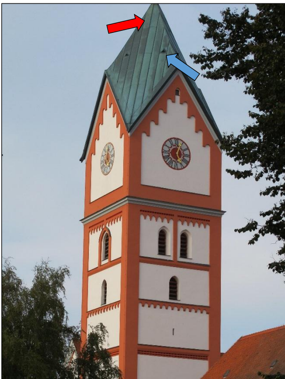
Abb. 2.2.5 – 3: Detail des Turmes der Klosterkirche in Scheuern, Hangplätze (roter Pfeil) und Ausflugsöffnungen (blauer Pfeil) sind hervorgehoben. (Foto: Geiger-Udod)
