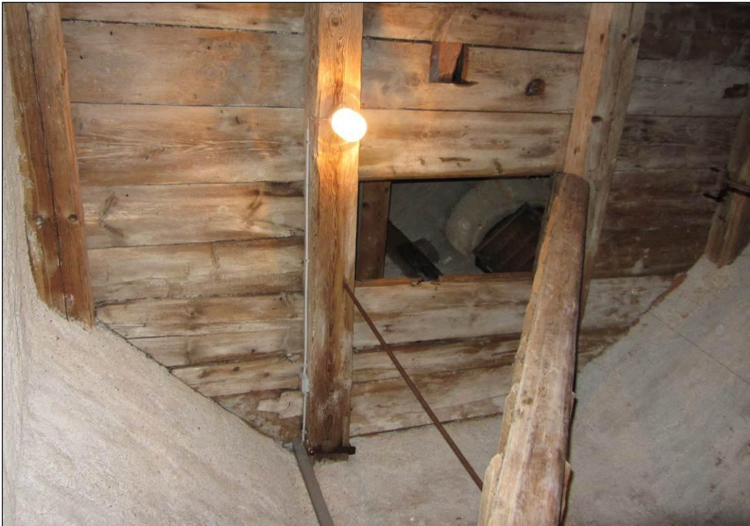
Abb. 2.2.4 – 5: Luke als Durchflug zwischen Turm und den Ausflugsöffnungen der unteren Ebene, Beleuchtung unterhalb der Luke
