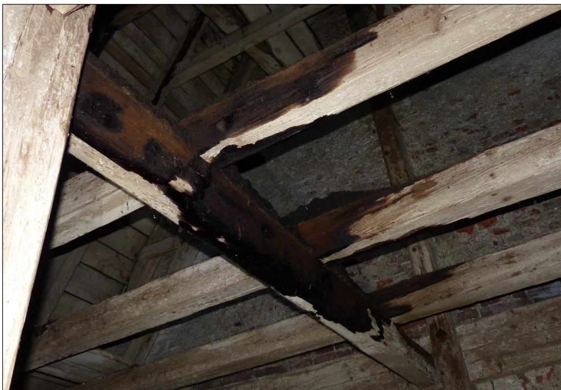
Abb. 2.2.3 – 7: Deutliche Verfärbung durch Fledermauskot an tragenden Querbalken
