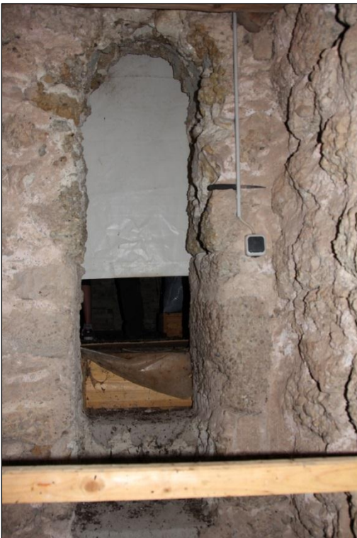
Abb. 2.2.2 – 4: Durchgang zwischen Dachboden und Turm, Ansicht vom Turm aus. Es wurde diskutiert, ob die Öffnung evtl. aus Brandschutztechnischen Gründen mit einer Feuerschutztüre verschlossen werden soll.
