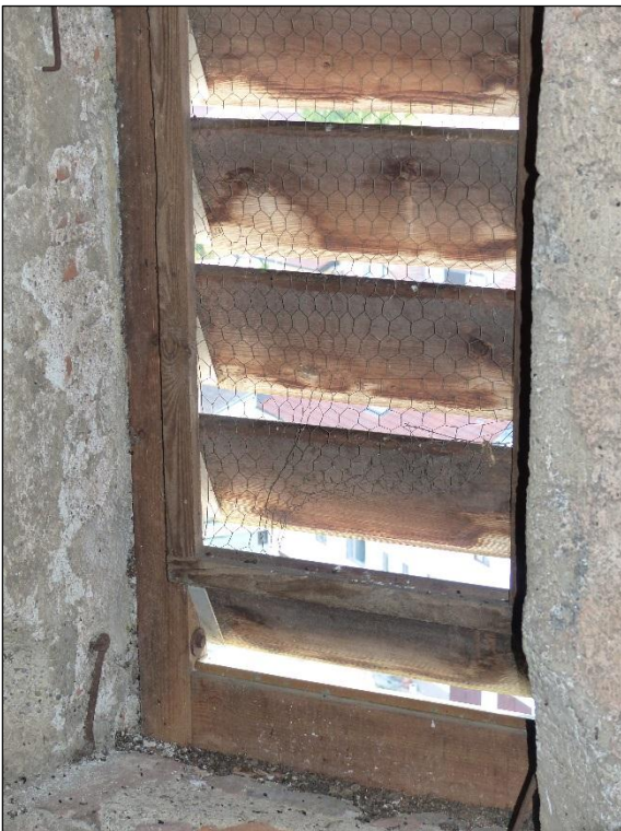
Abb. 2.2.4 – 4: Vergitterung der Schalluken der oberen Ebene, unten zurückgebogen mit Kotspuren
