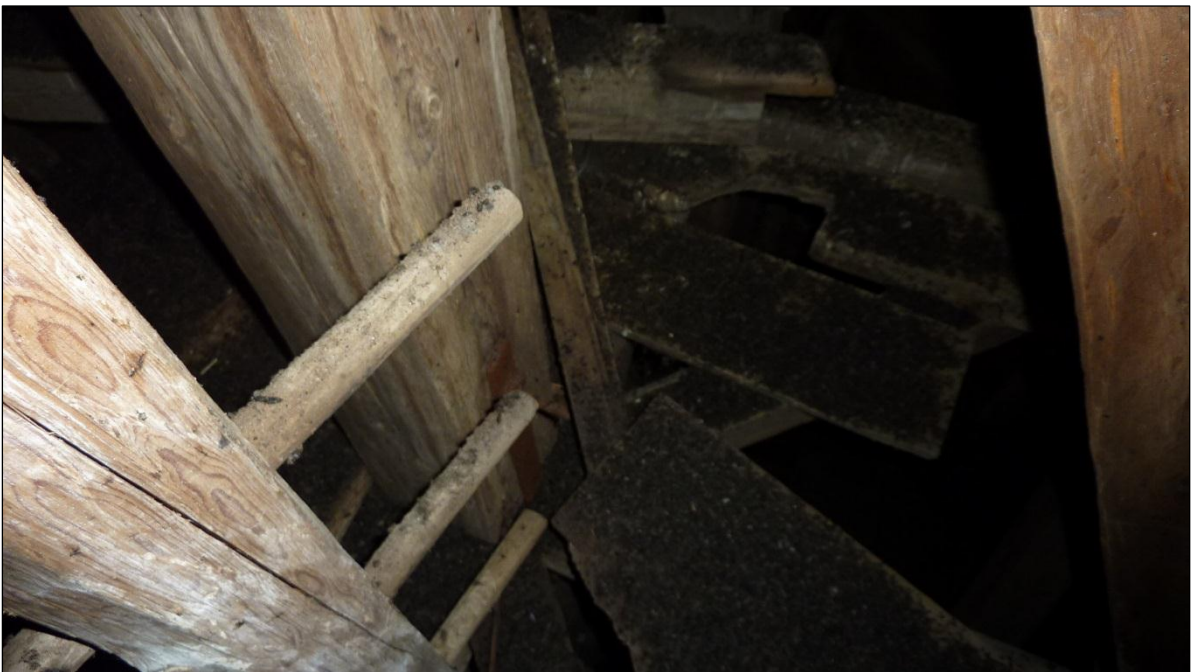
Abb. 2.2.5 – 4: Mittlerer Teil des Steigbaumes mit deutlichen Verunreinigungen, im weiteren Verlauf des Steigbaumes schwer begehbar. (Foto: Lustig)
