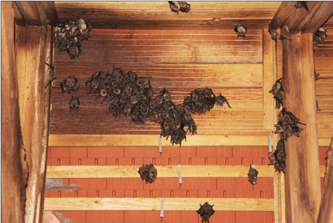
Abb. 2.2.2 – 7: Detail einer 2001 nachträglich eingebauten Wärmeglocke im Dachstuhl der Kirche mit einem Teil der Mausohrkolonie
