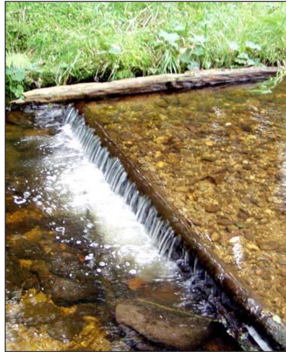
Abb. 208: Querverbauung mit Barrierewirkung am Schleicherbach
