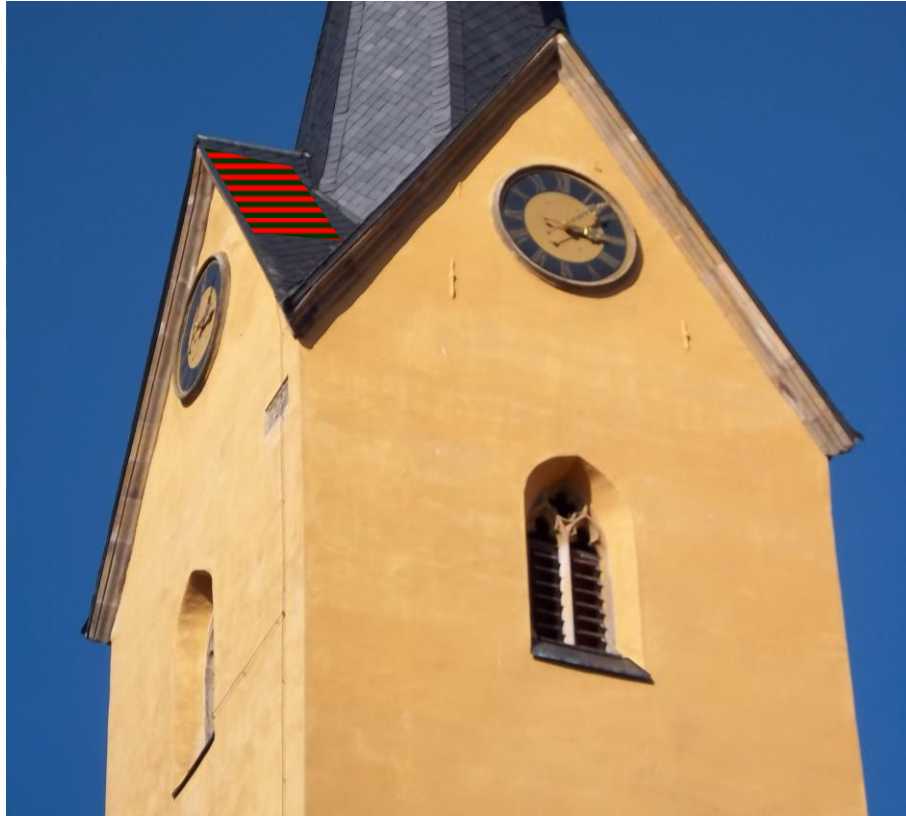
Abb. 29: Ausflugsöffnung (Schallluke) der Mausohr-Wochenstube an der Ev. Kirche in Hechlingen (TF 08), sowie genutzter Hangplatz (auf der zugewandten Seite der Dachhaut des Spitzhelms ist der Bereich der Hangplätze in der Fotografie rot schraffiert eingetragen). (Foto: B. Walk)
