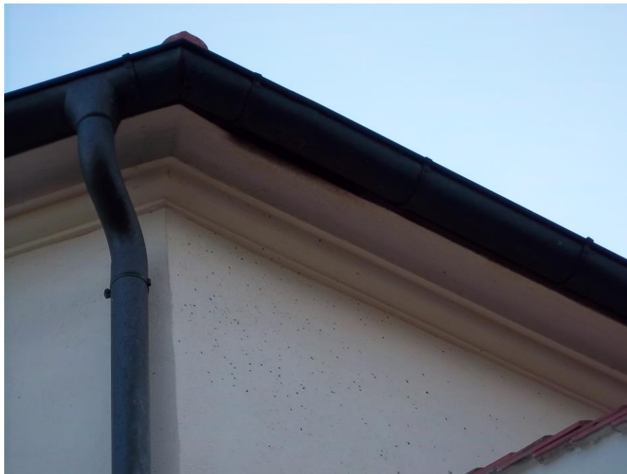
Abb. 32: Ausflugsöffnung der Mausohr-Wochenstube an der Traufe unter der Dachrinne der Kath. Kirche in Möhren (TF 09). Deutlich erkennbar ist die Verkotung an der Fassade. (Foto: B. Walk)
