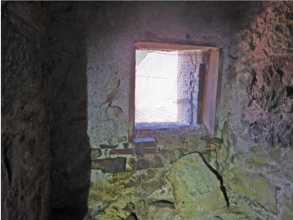
Abb. 17: Kirche in Duggendorf (TF 05): Fensteröffnung in einer der unteren Ebenen des Kirchturms, an dem sich in der unteren linken Ecke deutliche Abriebspuren von Mausohren erkennen lassen, die unter dem dort angebrachten Gitter krabbelnd hindurchschlüpfen. (Foto: B. Walk)
