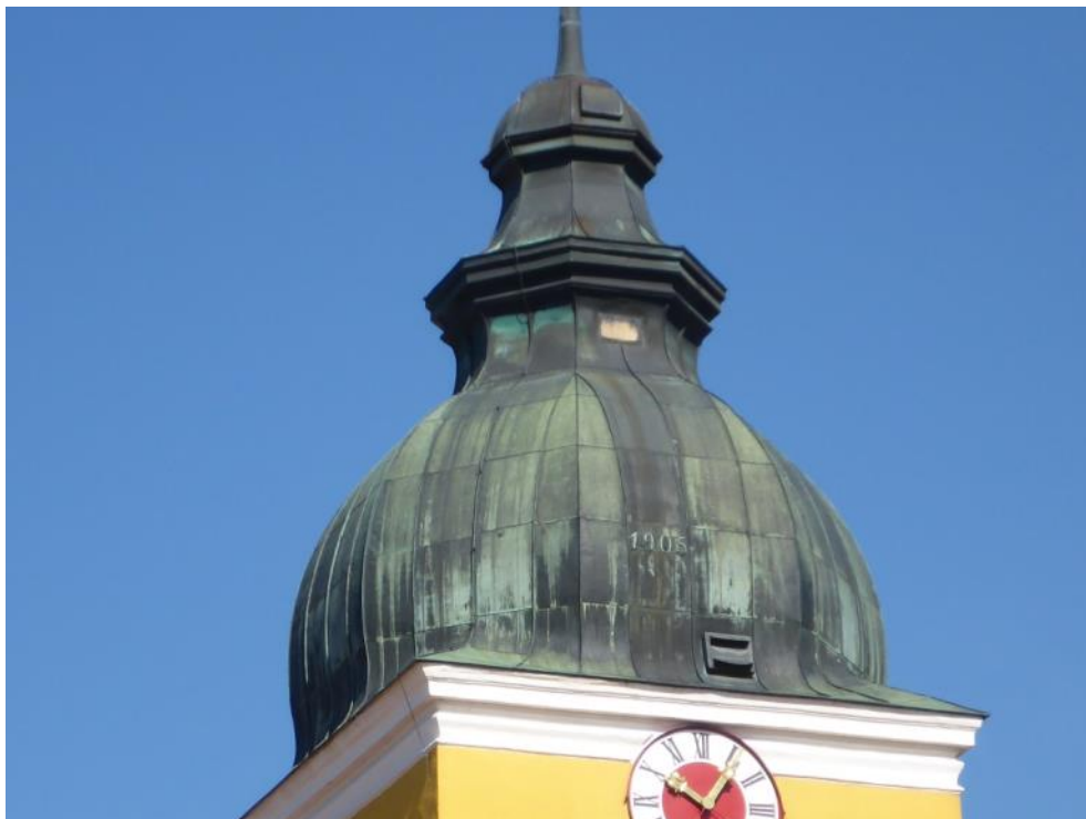
Abb. 29: Turmzwiebel der Kirche in Beratzhausen (TF 08) mit der Öffnung an der Basis und einer weiteren unterhalb des Blechgesimses. (Foto: B. Walk)
