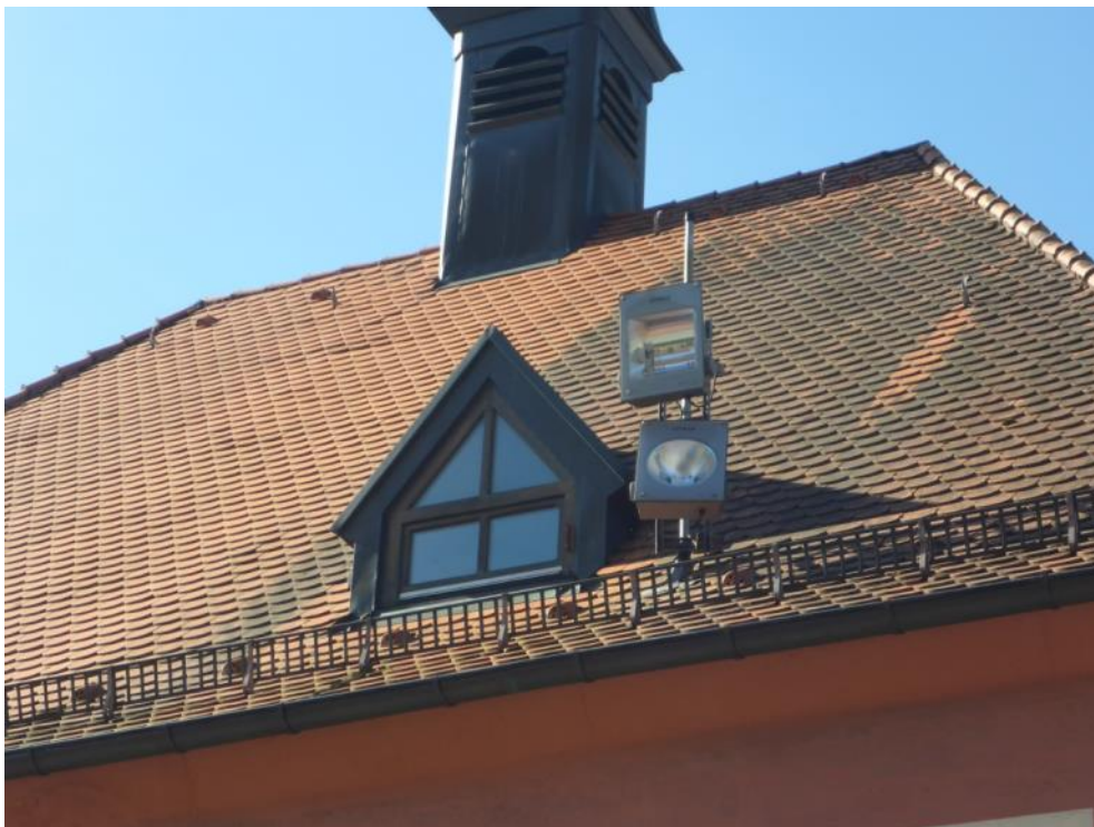
Abb. 31: Beleuchtungsanlage auf dem Dach des Rathauses (Marktstraße 33), mit der die Kirche in Beratzhausen (TF 08) im Winterhalbjahr angestrahlt wird. (Foto: B. Walk)
