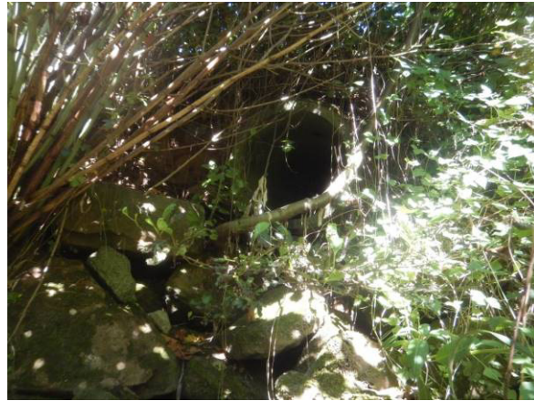
Abb. 17: Eine Mischwassereinleitungsstelle mit Rückständen von Hygieneartikeln im oberen Bereich der Befischungsstrecke 1; (Foto: MICHAEL KOLAHSA, Fischereifachberatung, 2018)
