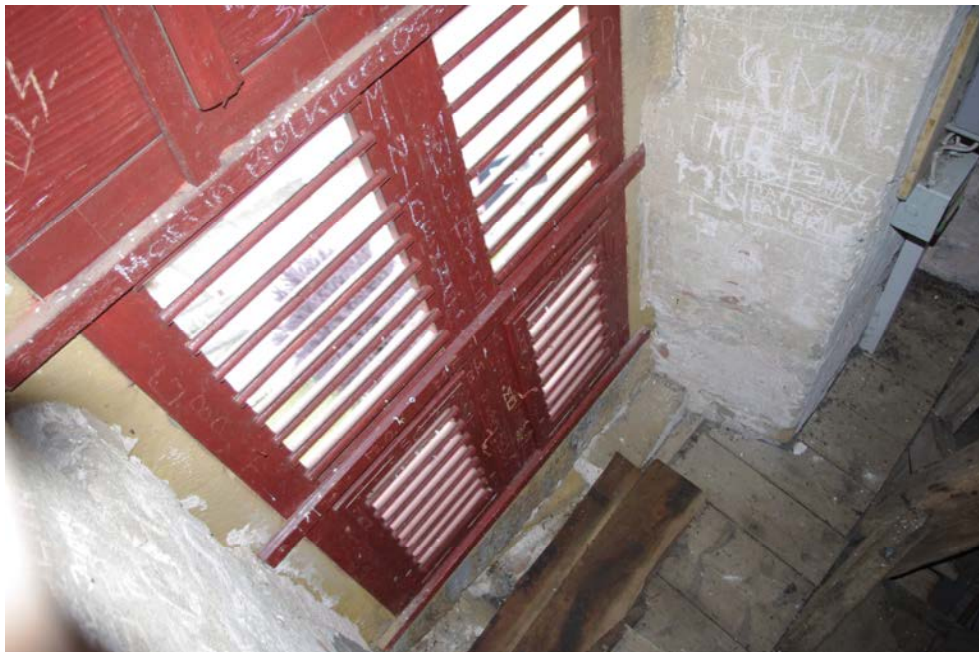
Abb. 6: Kath. Kirche Nankendorf: Der Ein- und Ausflug in den Turm erfolgt vermutlich vor allem durch die Schallluken (Foto: A. Niedling).
