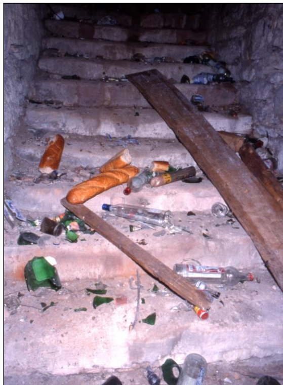
Abb. 12: Beeinträchtigung von TG 02: Vermüllung des Treppenabganges (bei verschlossener Kellertür) (Zustand Januar 2004). Foto M. Hammer
