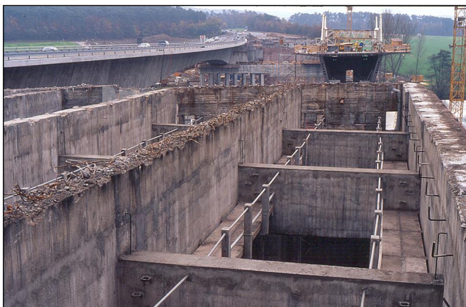
Abb. 21: Mainbrücke Bettingen der BAB A3 (TG .09). Das „Widerlager Frankfurt“ während der Baumaßnahmen (vgl. Text). Während des Winterhalbjahres 1999/2000 wurde die alte Fahrbahndecke des „Widerlagers Frankfurt“, also einer der Hauptangplätze der Kolonie, abgerissen und noch vor der Rückkehr der Fledermäuse im Frühjahr 2000 eine neue Betondecke erstellt (vgl. auch Abb. 19). Foto: M. Hammer
