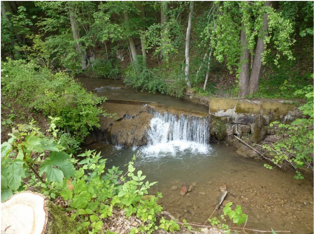
Abbildung 47: Fehlende Durchgängigkeit am Querbauwerk in der Krassach (Foto: H. Friedlein)
