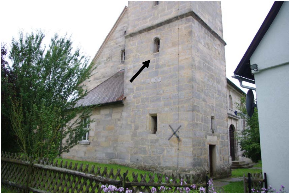
Abb. 10: Evangelische Kirche Neustädtlein: Eine der Hauptein- und Ausflugsöffnungen auf der Ostseite des Turmes (Pfeil). Aber auch die Schallluken bei den Glocken sowie weitere Fenster im Turm werden zum Ein- und Ausflug intensiv genutzt. (Foto: A. Niedling)
