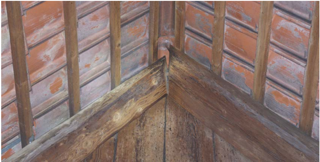
Abb. 7: Oblatenkloster Kronach: westlicher Giebelbereich, der vermutlich zum Aus- und Einflug genutzt wird (Foto: A. Niedling).
