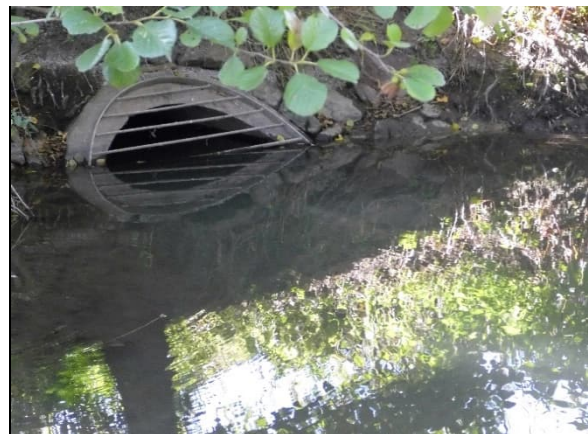
Abb. 26: Abwassereinleitung an die Fränkische Saale: Befischungsstrecke 4 unterhalb der Mündung der Lauer, nur bei Niedrigwasser sichtbar (Foto: MICHAEL KOLAHSA)
