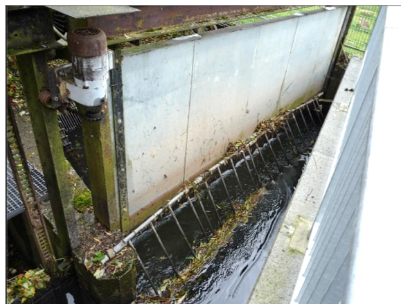
Abb. 23: Turbinenzulaufbereich der Herschfelder Mühle mit Grob- und Feinrechenbereich (Foto: MICHAEL KOLAHSA 2011)
