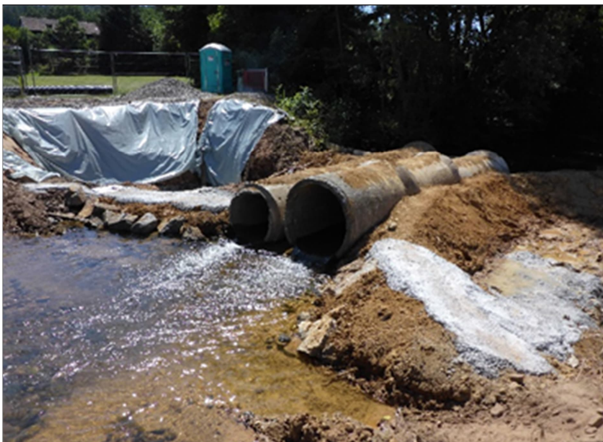
Abb. 24: Temporäre Verrohrung der Brend aufgrund einer Baumaßnahme ca. 700 m oberhalb von Befischungsstrecke 4 kurz oberhalb einer Furt. Diese Ausführung der Verrohrung ist für Koppen und Bachneunaugen nur bedingt durchgängig (Foto: MICHAEL KOLAHS, Fischereifachberatung 2019)
