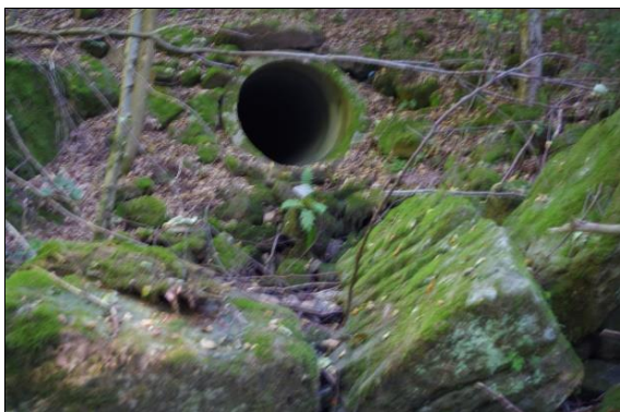
Abb. 38: Für Koppfen und Bachneunaugen nicht durchgängige Verrohrung an Befischungsstrecke 2 (Foto: MICHAEL KOLAHSA, Fischereifachberatung, 2018)
