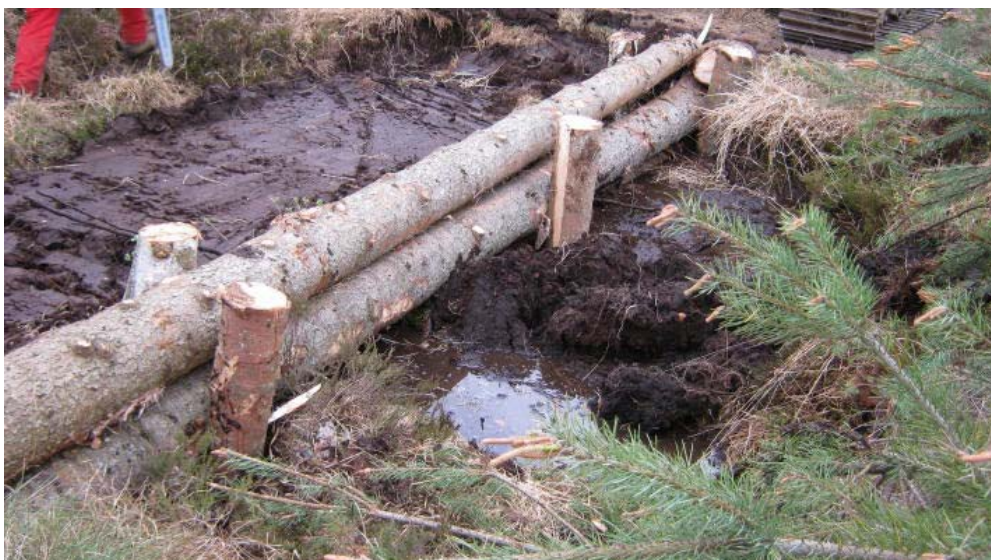
Einbau von Stammhölzern für einen großen Torfdamm zur Optimierung der Standsicherheit (vor der Abdeckung mit Torf)
