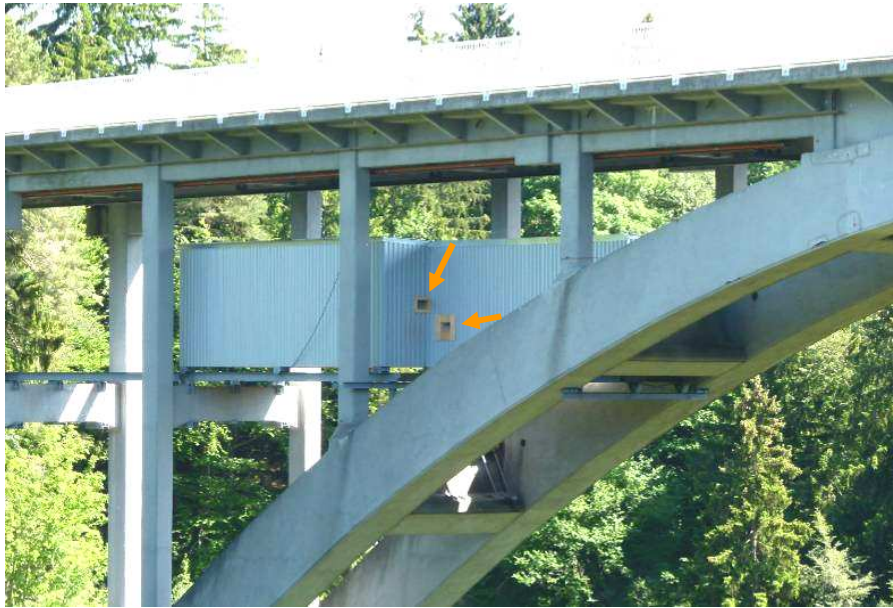
Abb. 13: Ersatzquartier (Kreis) an der Echelsbacher Brücke. Pfeile: Einflugsöffnungen.
