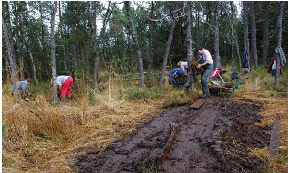
Schließen eines Moor-Entwässerungsgrabens durch den Bund Naturschutz Weilheim: Zwischen eingeschlagenen Holzpallisaden wird eine verdichtete Torfpackung zuletzt mit abgestochenen Grassoden überdeckt. So wird ein optimaler, dauerhafter Wasserstau gewährleistet (Foto: Andreas Zehm).
