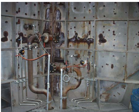
Abb. 7: Injektoren und Temperaturmessstellen auf 24 m
