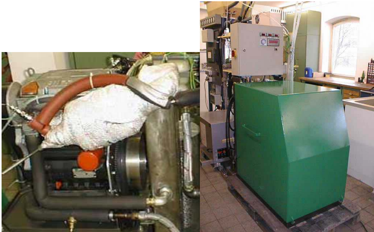
Abbildung 4.47: BHKW der Vereinigten Werkstätten für Pflanzenöltechnologie
