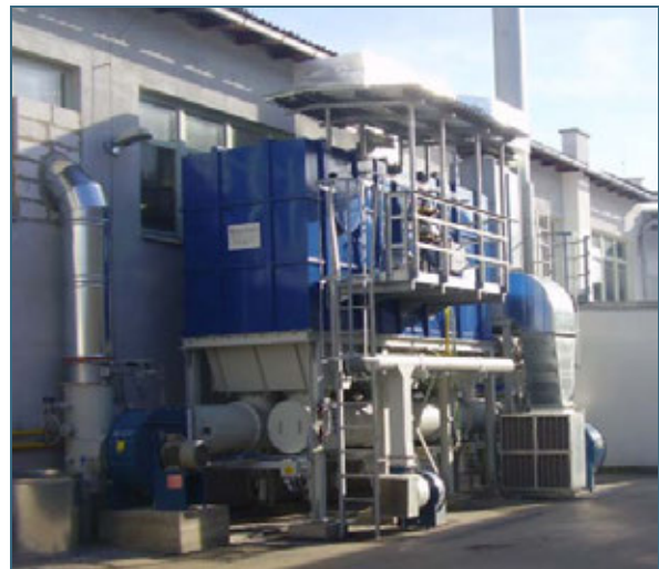
Abb. 12: Regeneratiive thermische Oxidation
