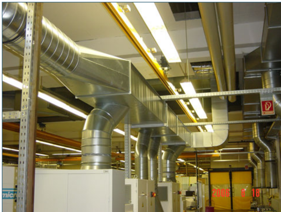
Abb. 13: Die Abwärme wird an der Wärmequelle gefasst.
