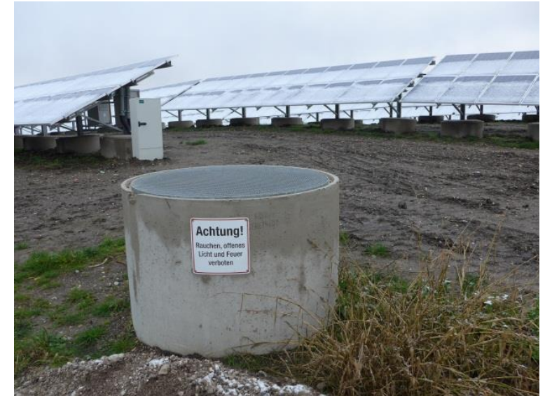
Gasbrunnen zwischen den Photovoltaikmodulen
