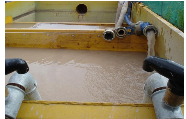
Einrichtung zur Bauwasserhaltung
