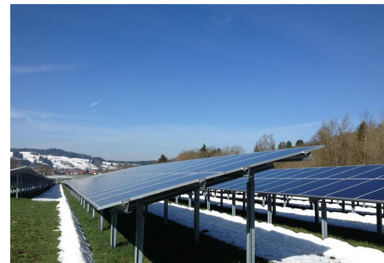
Neue Photovoltaikanlage auf der eh. Deponie Letz, März 2014
