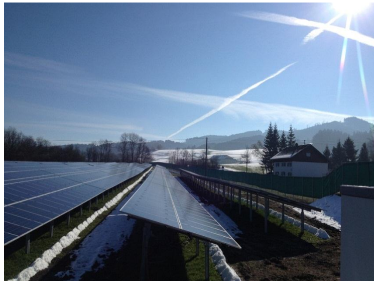
Nach Inbetriebnahme im März 2014
