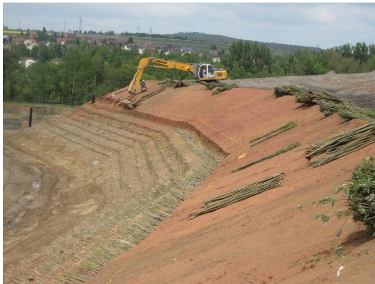
Stufenförmiger Abtrag der oberen Bodenschicht zur Herstellung der Weidenbuschlagen an der Böschung, Mai 2009
