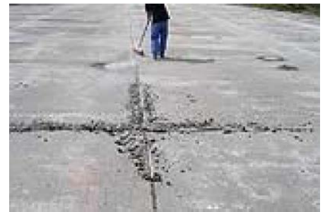
Abb. 3: Teerfugen zwischen Betonplatten
