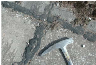
Teervergussmasse zwischen Betonbodenplatten
