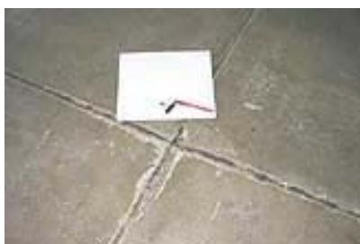
PAK-haltige Fugenmasse zwischen Betonplatten im Innenbereich
