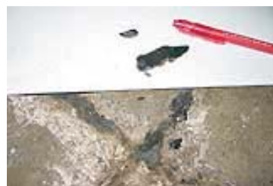
PAK-haltige Fugenmasse (Detail)
