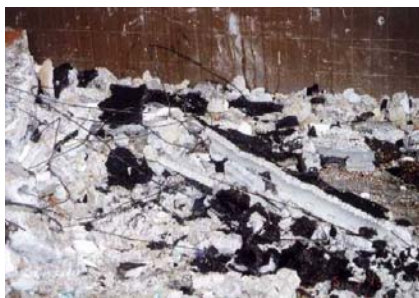
Zerbrochene Teerkorkisolierung im Bauschutt
