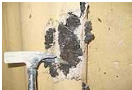
Rohrisolierung aus Teerkork (schwarz) mit Gipsmantel (beige)
