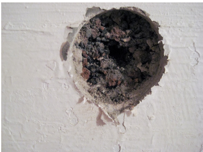
Abb. 3: Verdeckte Teerkorkdämmung hinter Wandputz
