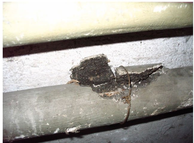
Abb. 2: Rohrisolierung aus Teerkork
