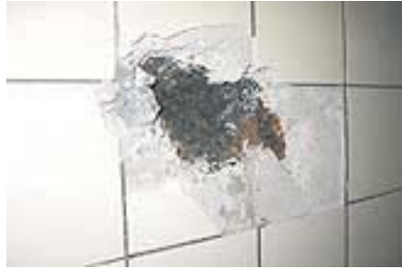
Teerkork-Wandisolierung unter Mineralputz (weiß) mit Fliesen
