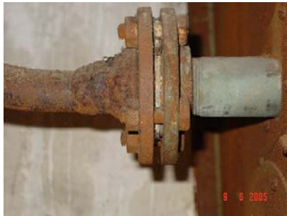
Rohrflansch mit asbesthaltiger Dichtungspappe
